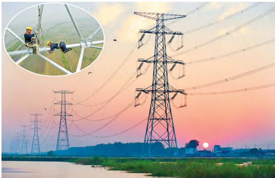
淮南—南京—上海线1000千伏交流特高压输电线路（金湖段）晨景 梁德斌 摄
